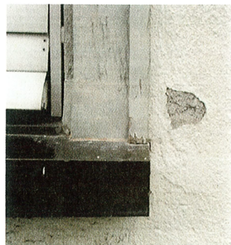
Schadensbild vom Fenstergewände, Detailaufnahme.
